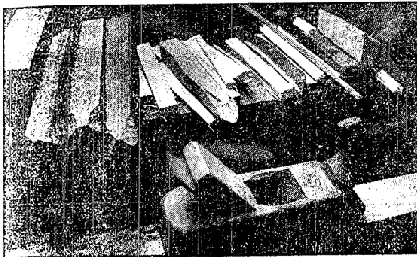
Auch Holzriegel müssen erneuert werden.
