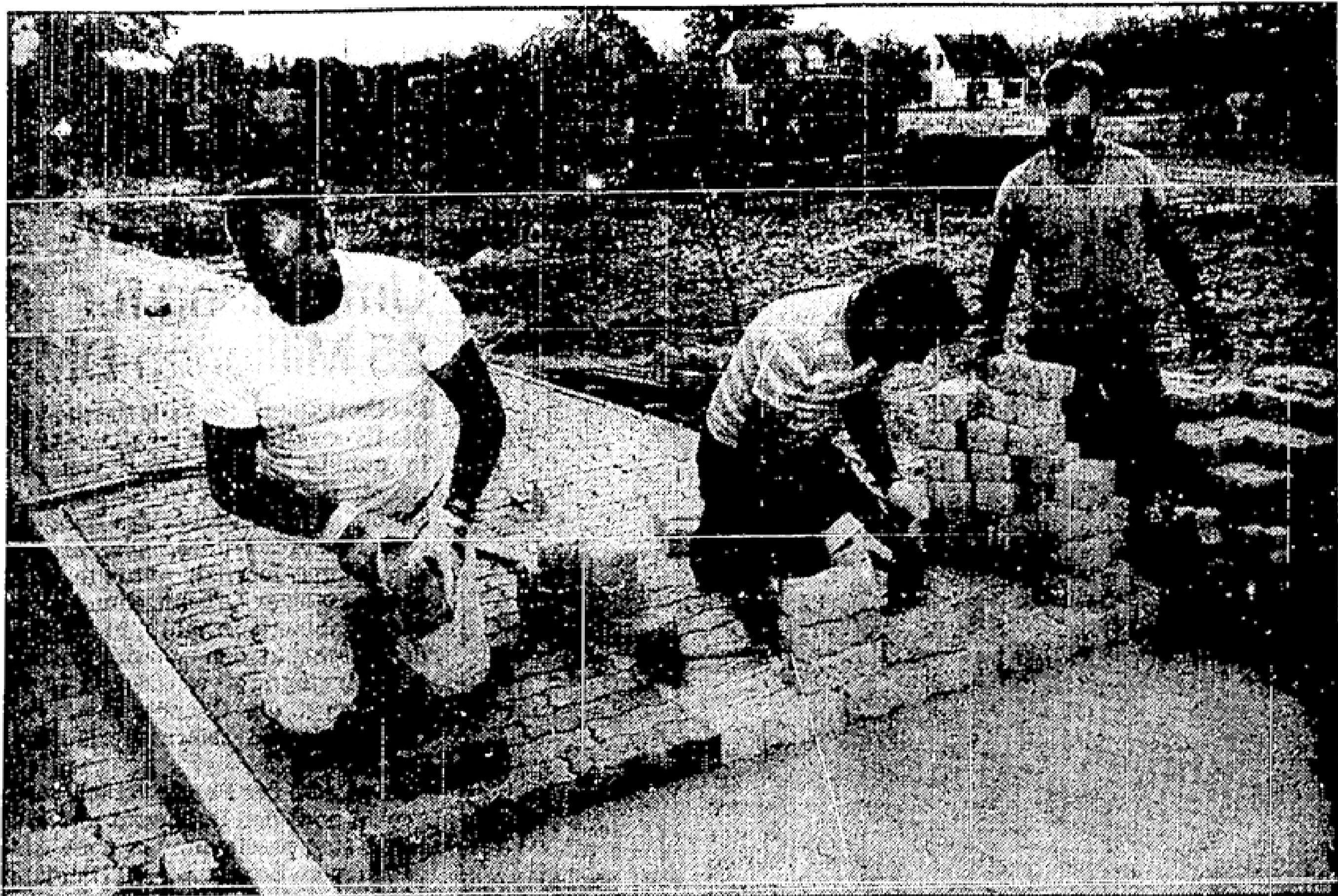
Gehwegbau in Beeskow (Gewerbegebiet) EROWA links Dieter Becher, mitte Dietmar Nemark, r. Horst Sawally
