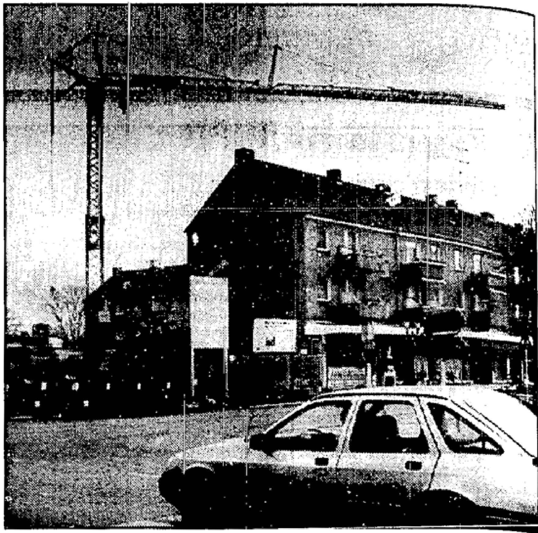
Es geht offenbar mit der Eckbebauung in Beeskows Innenstadt voran. Seit Montag steht ein hoher Kran an der Baugrube. MOZ-Foto: Jur
