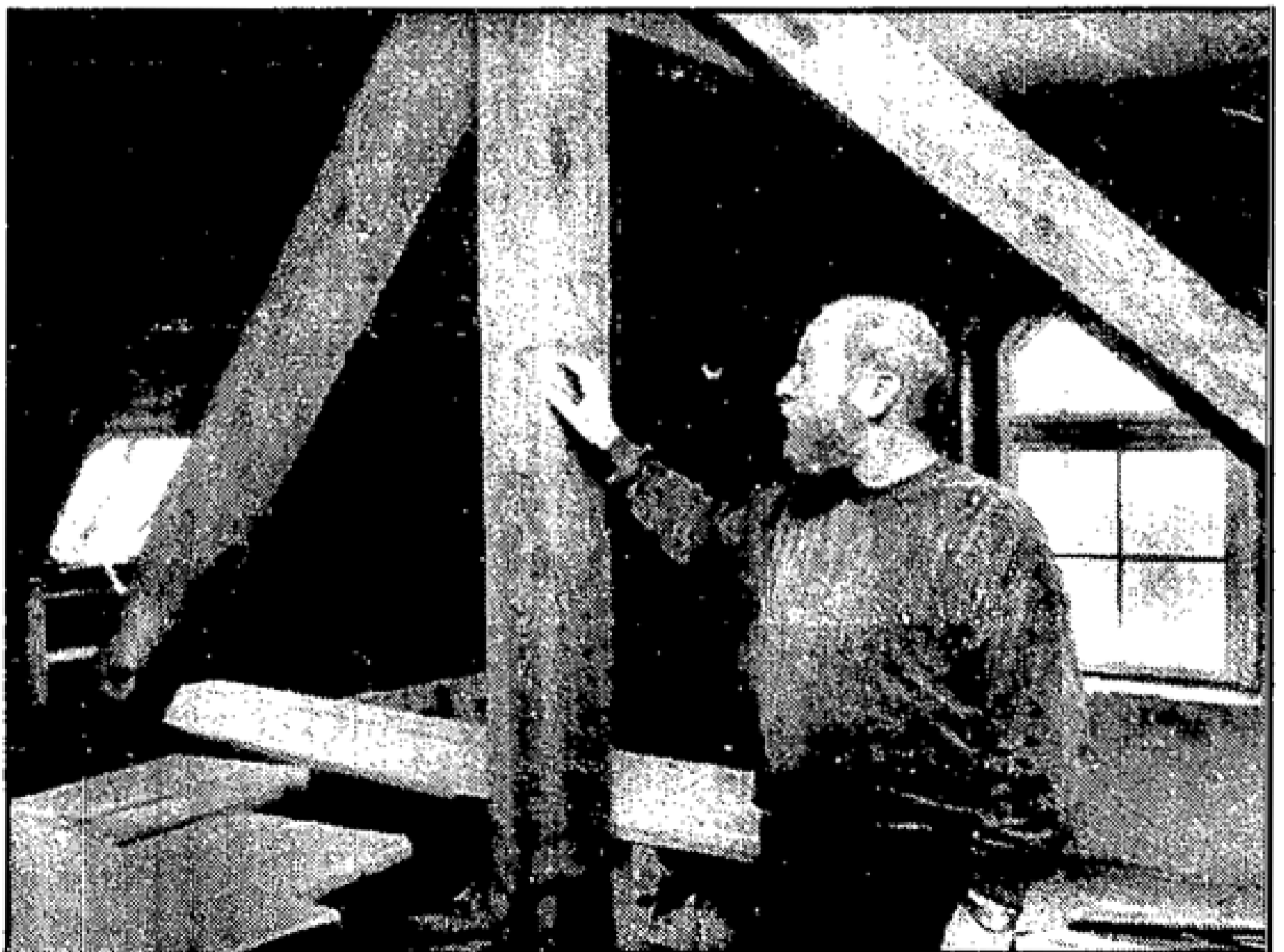
Hier soll einmal das Kulturamt einziehen, erklärt Hans-Jürgen Bahr, Sachgebietsleiter Zentrale Dienste, auf dem Dachboden des Landratsamtes.
