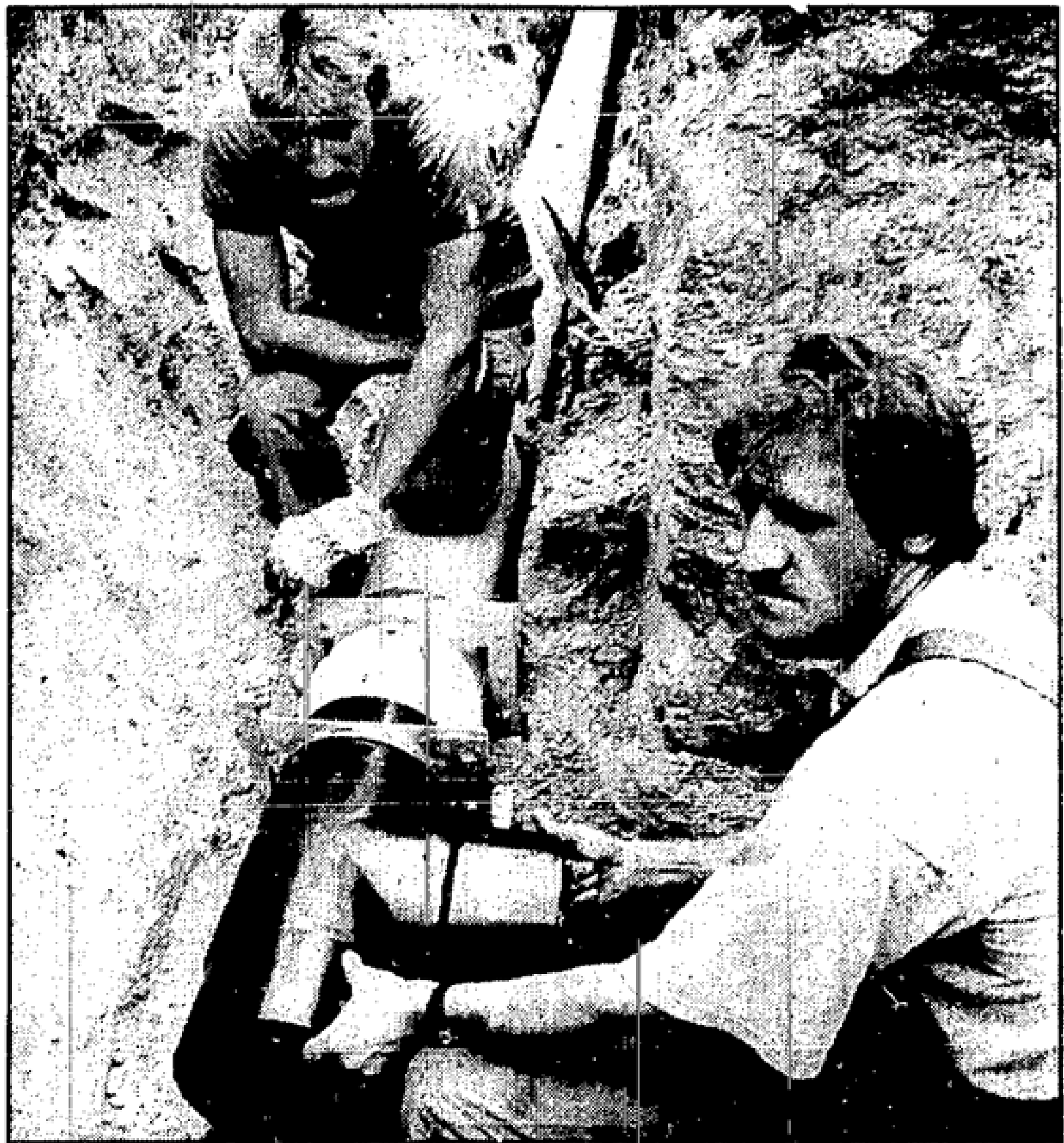
Thorsten Zierott (links) und Frank Aust beim Einbau eines Absperrschiebers an der neuen Gasleitung in der Beeskower Schützenstraße MOZ-Fotos (2): Jur
