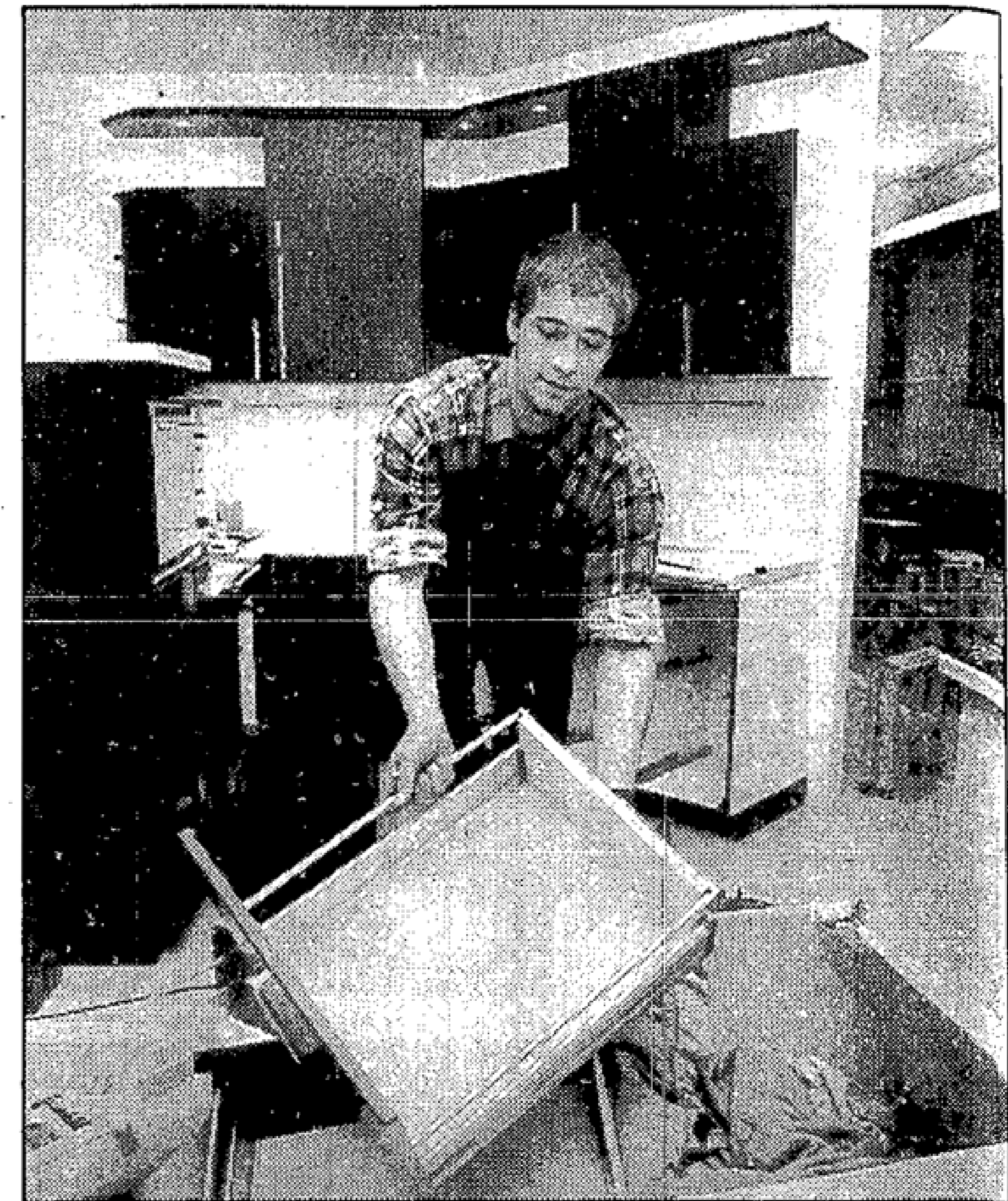
In den letzten Zügen befindet sich der Aufbau des Küche Marke Florida. Nico Krüger muß rasch arbeiten, um rechtzeitig fertig zu sein.
