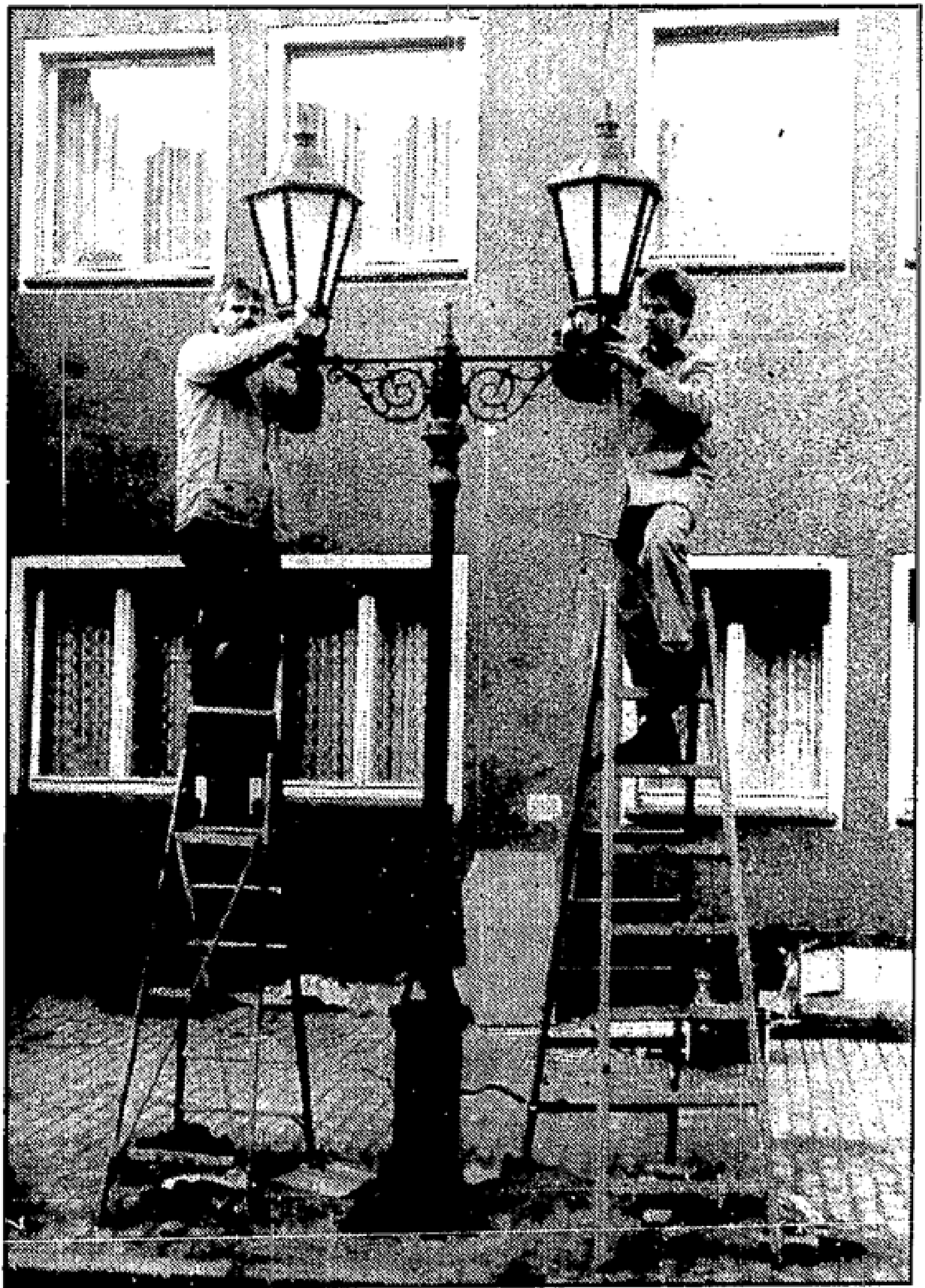
Zwei Leitern, zwei Männer und ein zweiflammiger Kandelaber. Und schon ist die Straßenbeleuchtung in der Beeskower Innenstadt wieder perfekt, nachdem ein recht rasanter Autofahrer eines der noch recht neuen Schmuckstücke „umgenietet“ hatte.
