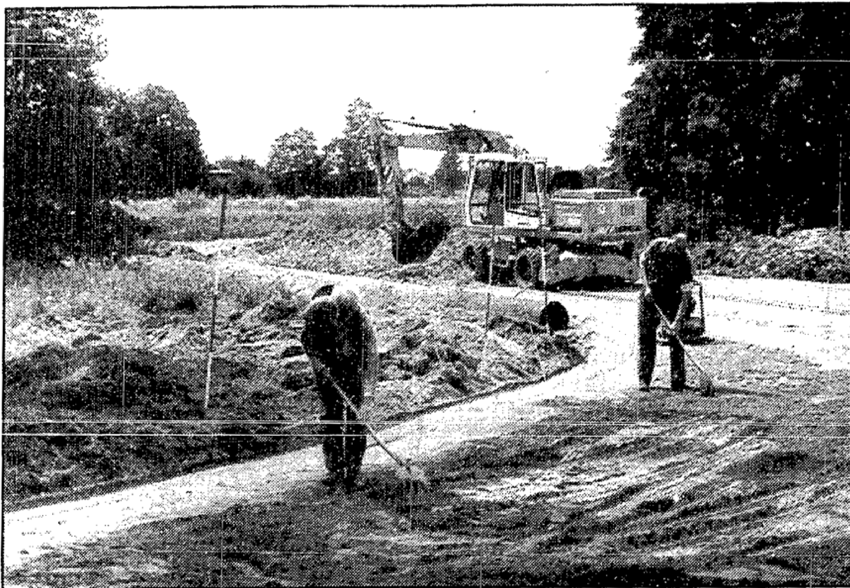
Vollkommen neu soll die Brücke übers Oegelner Fließ am Ortseingang von Beeskow gebaut werden. Zur Zeit sind Arbeiter des Beeskower Hoch-, Tief- und Straßenbaubetriebes dabei, eine kleine Umgehungsstraße anzulegen. Im Bild: Kurt Romaikat (links) und Hans Peter Löser bei den Bauarbeiten. Foto: Karl-Heinz Arendsee
