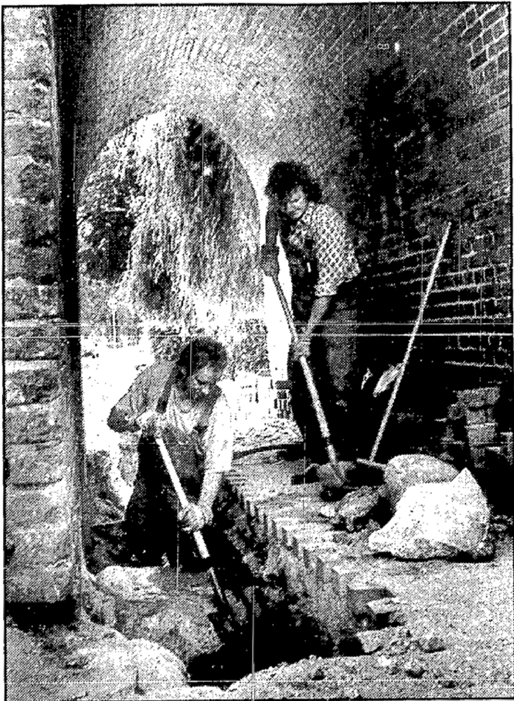
Kompliziert war für die Bauarbeiter Andreas Schade und Frank Hotzan (rechts) das Ausschachten des Grabens für die Erdgasleitung, weil das Fundament des Beeskower „Dicken“ nicht in Mitleidenschaft zu gezogen werden durfte
