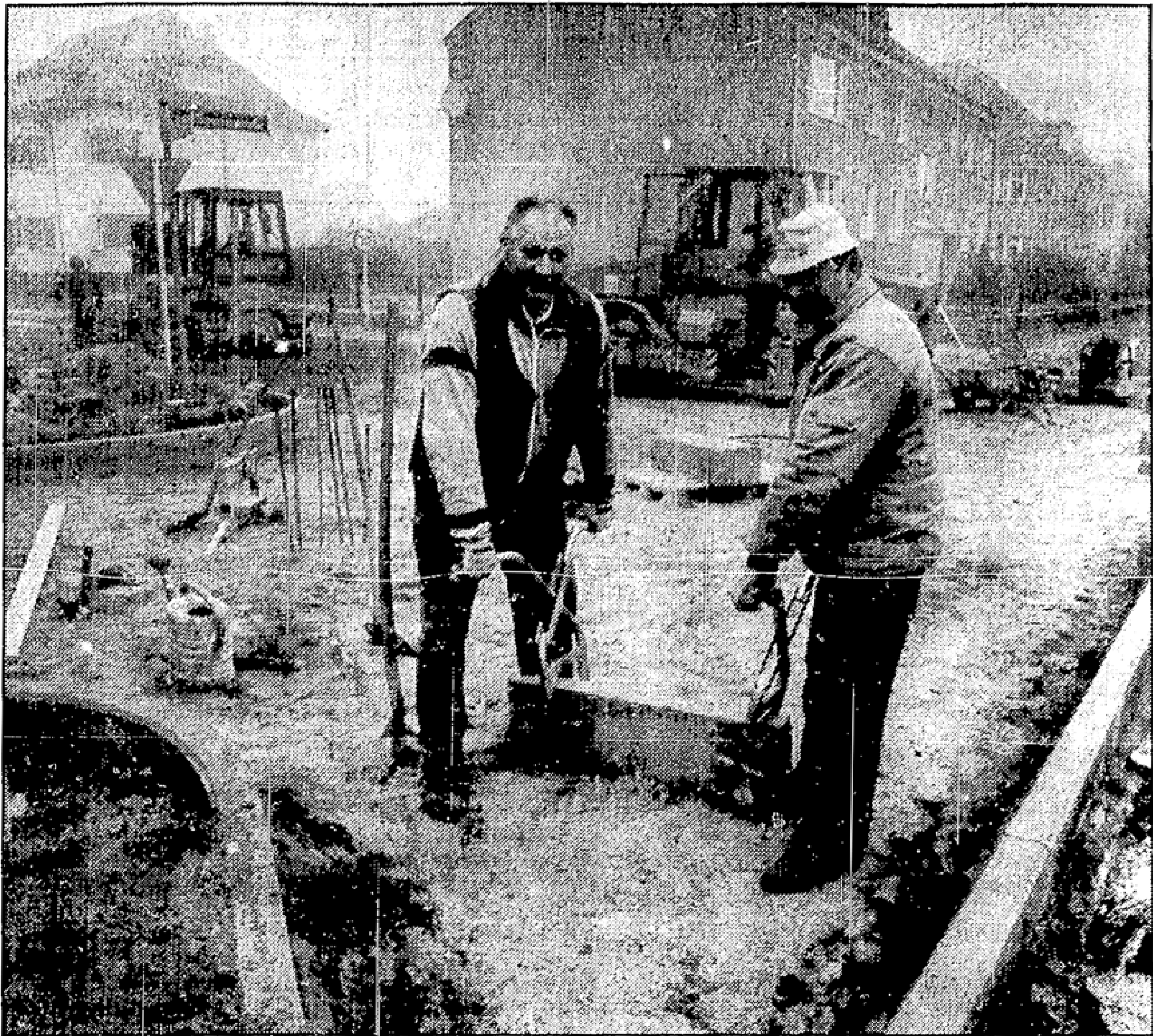
Straßenbauarbeiten in Beeskow: Befestigt wird in diesen Tagen der Wiesenring zwischen Liebknechtstraße und Rouanetstraße. Dieter Becker (l.) und Hans Miethe von der Erowa-Bau setzen gegenwärtig Bordsteine. Fast fertiggestellt ist die Einmündung der Schützenstraße in die Breitscheidstraße.
