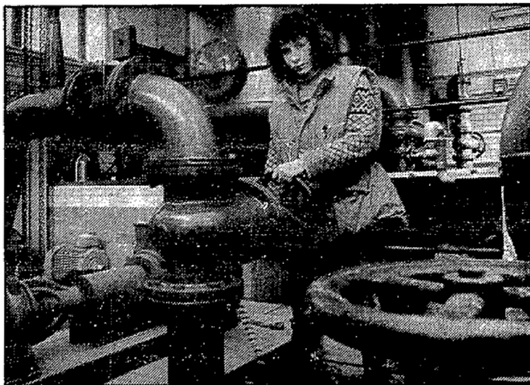
Den Schieber auf und Wasser marsch – Wasserwerkerin Katrin Elsner betreut die Druck-Erhöungsstation in der Kohlsdorfer Chaussee in Beeskow.
